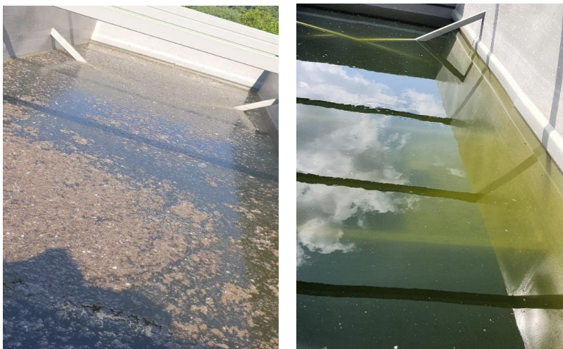
Figuur 22: Algen voor (links) en een paar dagen na (rechts) de plaatsing van de ultrasoon
