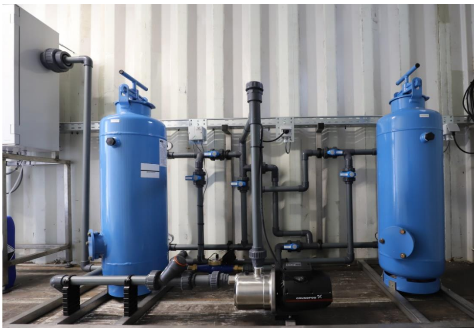
Figuur 19: De zuivering bestaat uit een zandfilter, actief koolfilter en waterstofperoxide dosering.
