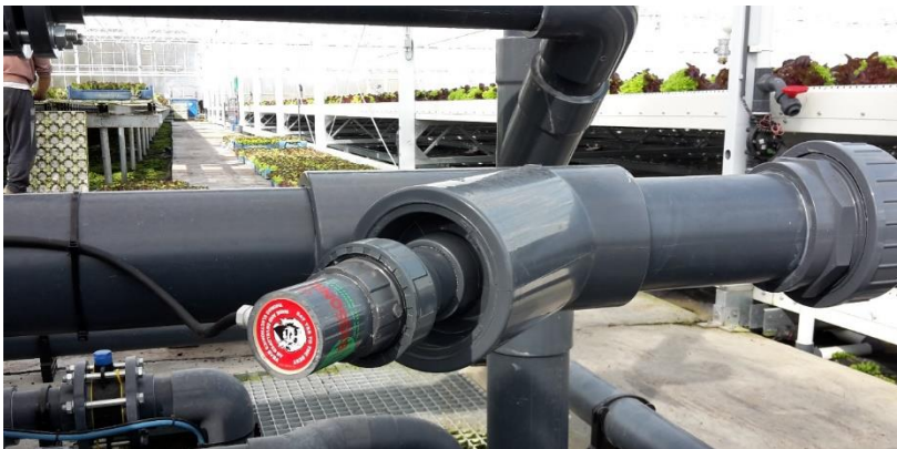
Foto 2. Voorbeeld van een Biosonic, geplaatst op de leiding net voordat het water vertrekt naar het verdeelsysteem in de serre.
