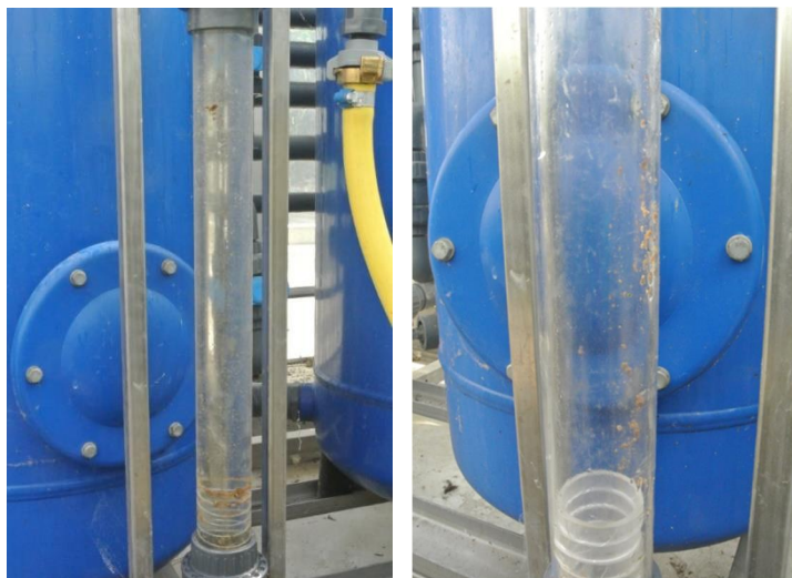
Foto 5. Na 3 weken proef draaien vertoonde de binnenkant van de buis van de monitoringsunit van het onbehandelde object aanslag van organisch materiaal.
